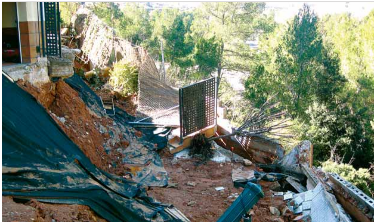
La zona comunitària de davant de la casa més afectada per la caiguda del mur de contenció ha baixat uns quants metres ■ AVUI
